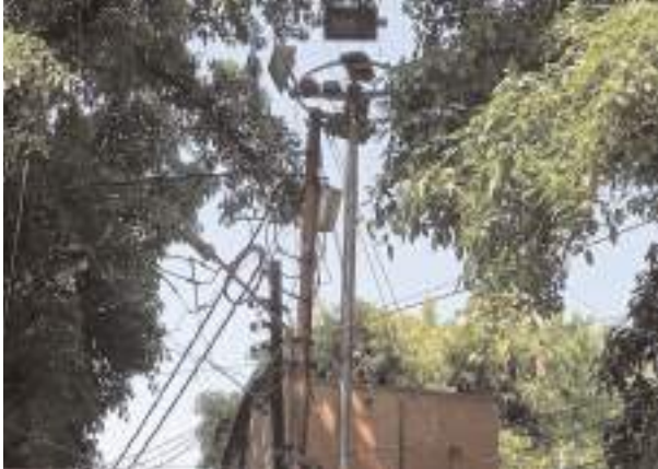
जिला स्कूल के पास खराब सोडियम लाइट
