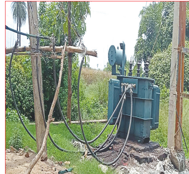
समधन पश्चिमी स्वागत द्वार गेट के पास खुले में रखा ट्रांसफार्मर व टाकुरद्वारा के निकट झूलती जर्जर बिजली केबिल
